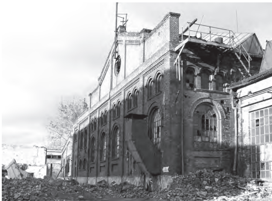
Ryc. 6. Jedna z wielu nieistniejących już zabytkowych hal i obiektów gliwickiej huty. Wszystkie zostały wyburzone pod budowę centrum handlowo-rozrywkowego Focus-Park. (fot. M. Żmudzińska-Nowak)
